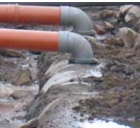
Deze gescheiden privé-riolering komt uit op een (voorlopig) gemengd rioleringsstelsel.
